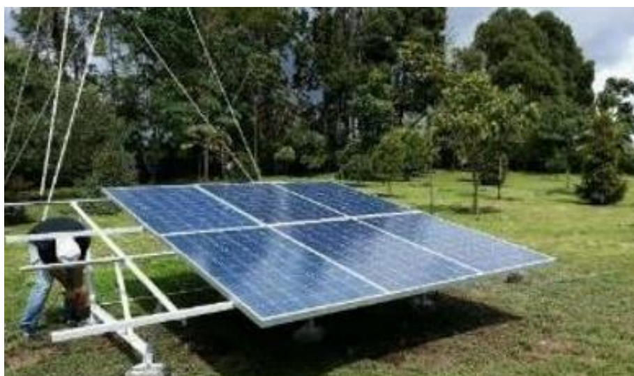
Imagen 1: De esta manera se instalaron los primeros paneles solares de Erco. Tomado de la conferencia Emprender por segunda vez: caso Erco-Neu
